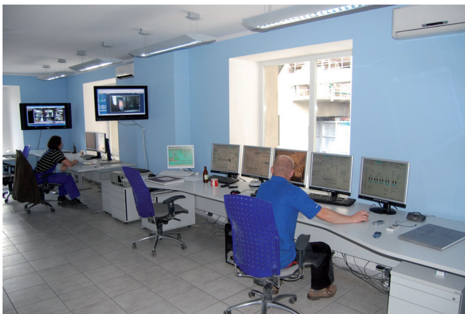
Fot. 10. Centralna sterownia
