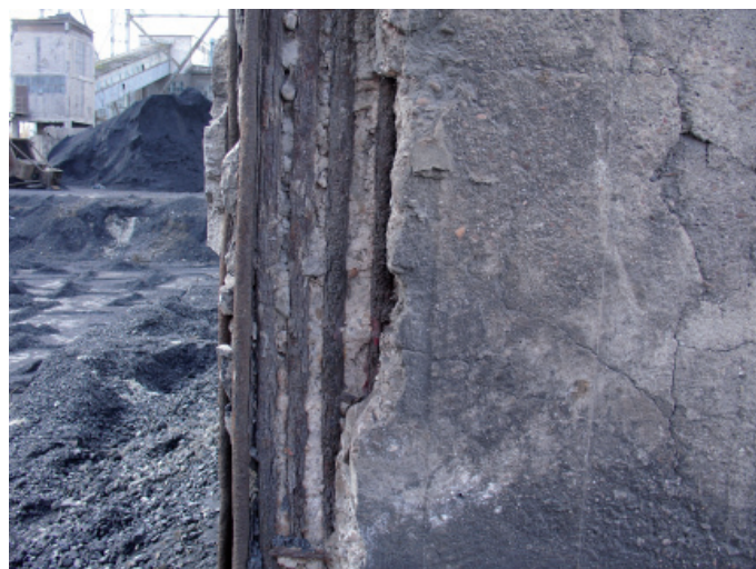
Rys. 4. Uszkodzenia otuliny betonowej słupa w składzie węgla
