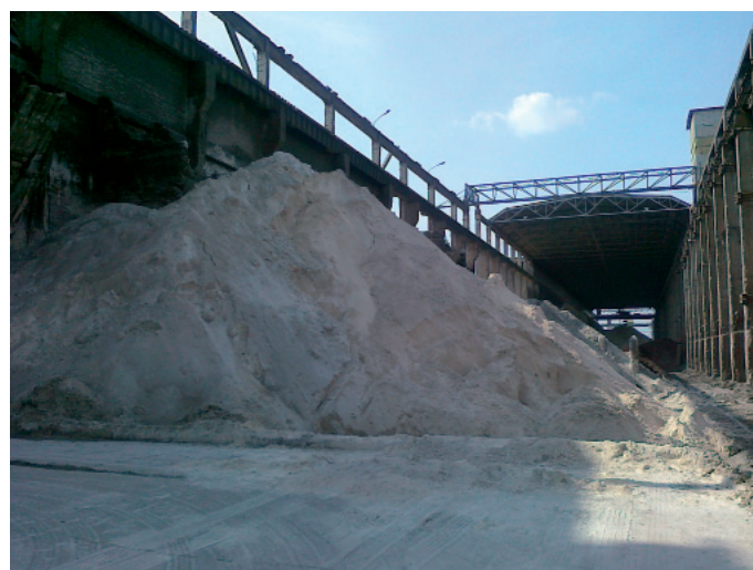
Rys. 9. Słupy zasypane hałdą gipsu
