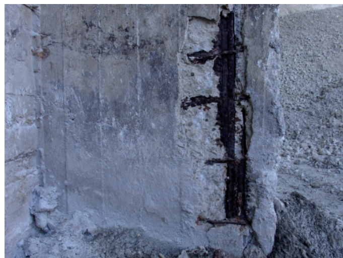
Rys. 7. Uszkodzenia słupa 1 w składzie gipsu. Z prawej strony słupa widoczna hałda gipsu
