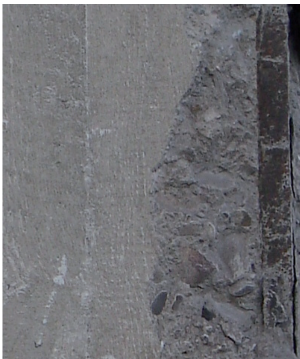
Rys. 3. Fragment zbrojenia słupa w składzie węgla, po odkuciu otuliny betonowej. Dobry stan betonu, brak korozji zbrojenia
