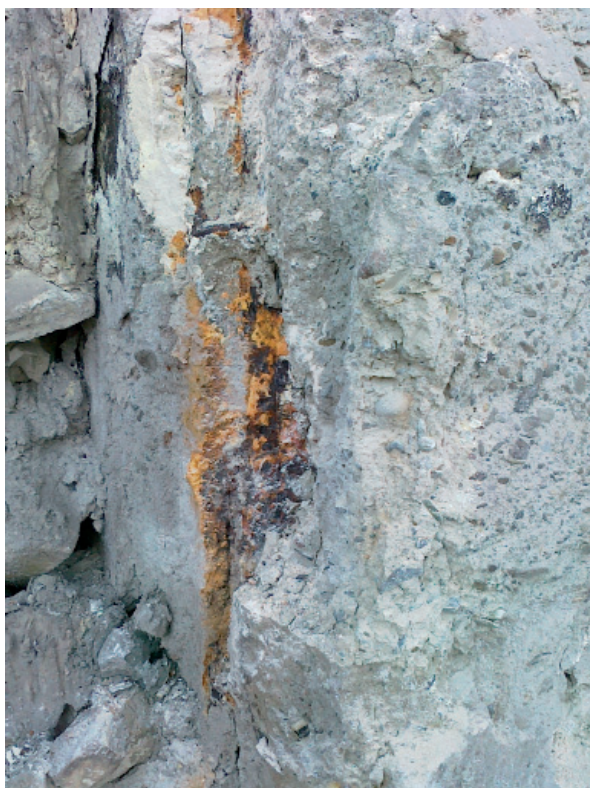
Rys. 8. Zaawansowana korozja zbrojenia w słupie 2 na składowisku gipsu
