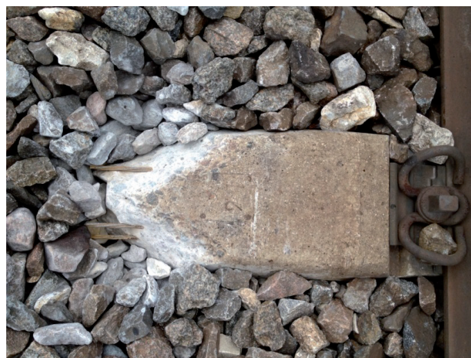
Rys. 6. Podkład betonowy popękany w wyniku opóźnionego powstawania ettringitu
