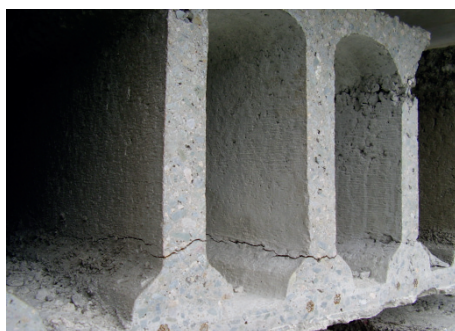
Rys. 7. Rozłupywanie czoła kanałowej płyty stropowej Fig. 7. Spalling at the face of hollowed floor slab
