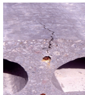
Rys. 9. Rozszczepienie płyty kanałowej, sprężonej splotami Fig. 9. Splitting at the hollow core floor slab prestressed with strands
