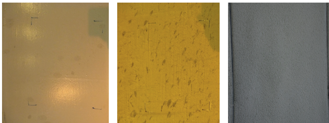
Rys. 3. Przykłady rodzajów farb tunelowych z różnymi poziomami zanieczyszczenia (po lewej i w środku) oraz z białym torkretem (po prawej) [VÖZFI] Fig. 3. Examples of tunnel paint systems with different contaminations (on the left and in the middle) as well as with white shotcrete (on the right). [Source: VÖZFI]
