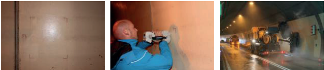
Rys. 1. Rejestracja współczynników luminacji w 5 różnych lokalizacjach przed i po oczyszczeniu tunelu [SMG]
