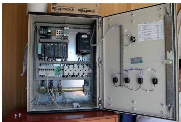
c: Szafka sterownicza do sterowania oświetleniem c: Control cabinet for lighting control
