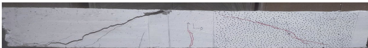
c) L0 Wzorzec pęknięcia belki - zniszczenie przez ścinanie c) L0 Beam crack pattern at ultimate – failed in shear
