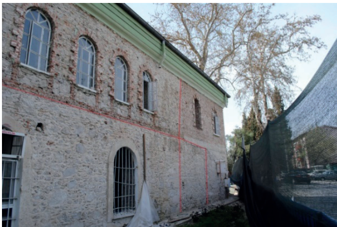
Rys. 3. Różnice w fakturze i dylatacjach ścian wschodnich budynku
