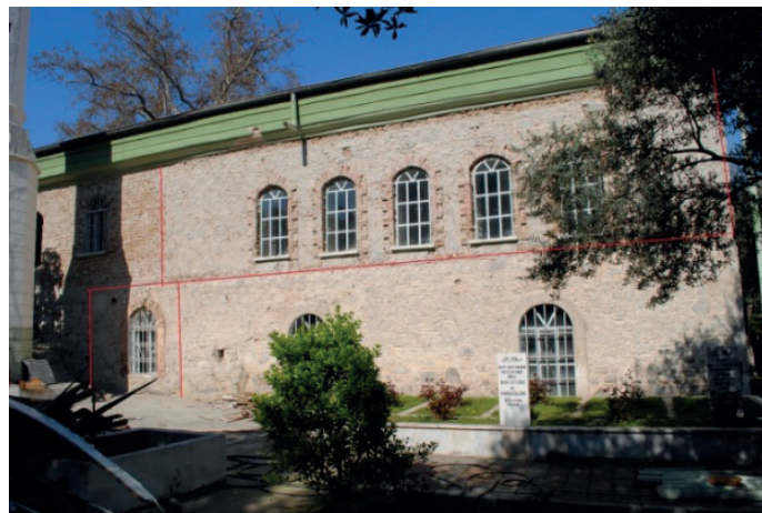
Rys. 4. Różnice w fakturze i dylatacjach ściany zachodniej budynku
